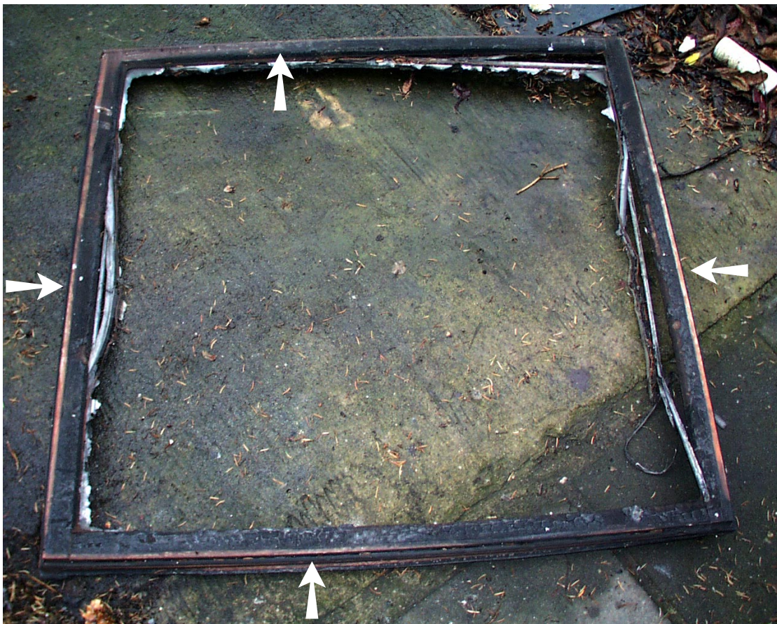
Bild 11 Außenseite des linken Fensterflügels zeigt Brandspuren die eindeutig den geschlossenen Zustand des Fensterflügels während des Brandes beweisen
